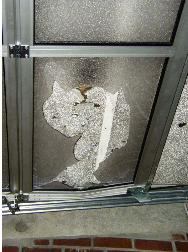
Bild 1: Beschädigung am geöffneten Sektionaltor und an der Deckenverkleidung
