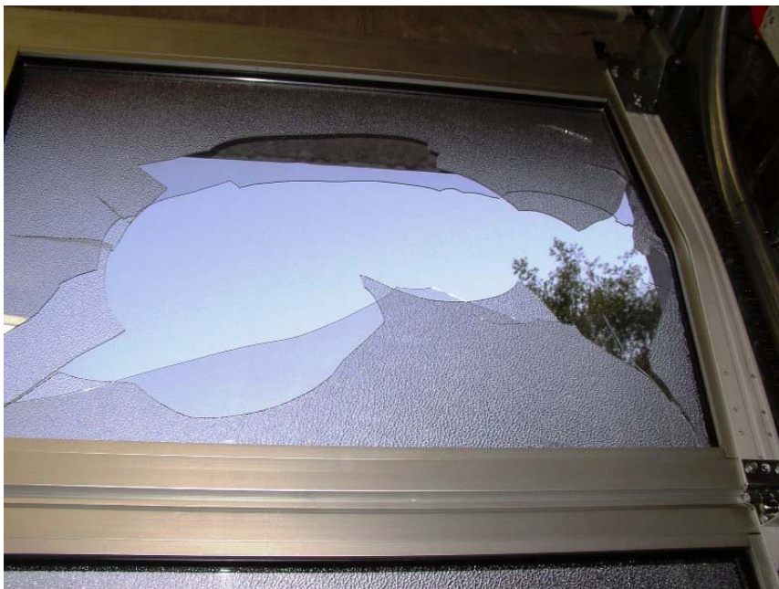
Bild 2: Beschädigung am selben Sektionaltor in geschlossenem Zustand
